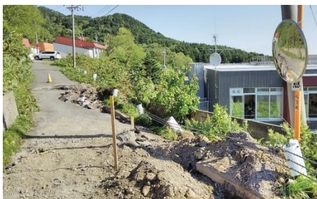
香深中脇の教員住宅へ通じる道路の様子
